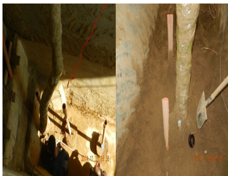
图 17 第 2 组试验钢花管破坏现场照片
